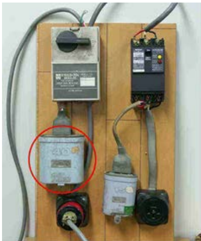
コンデンサ設置状況
