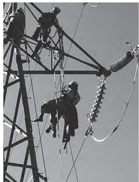
特殊施設対応訓練(変電所)
