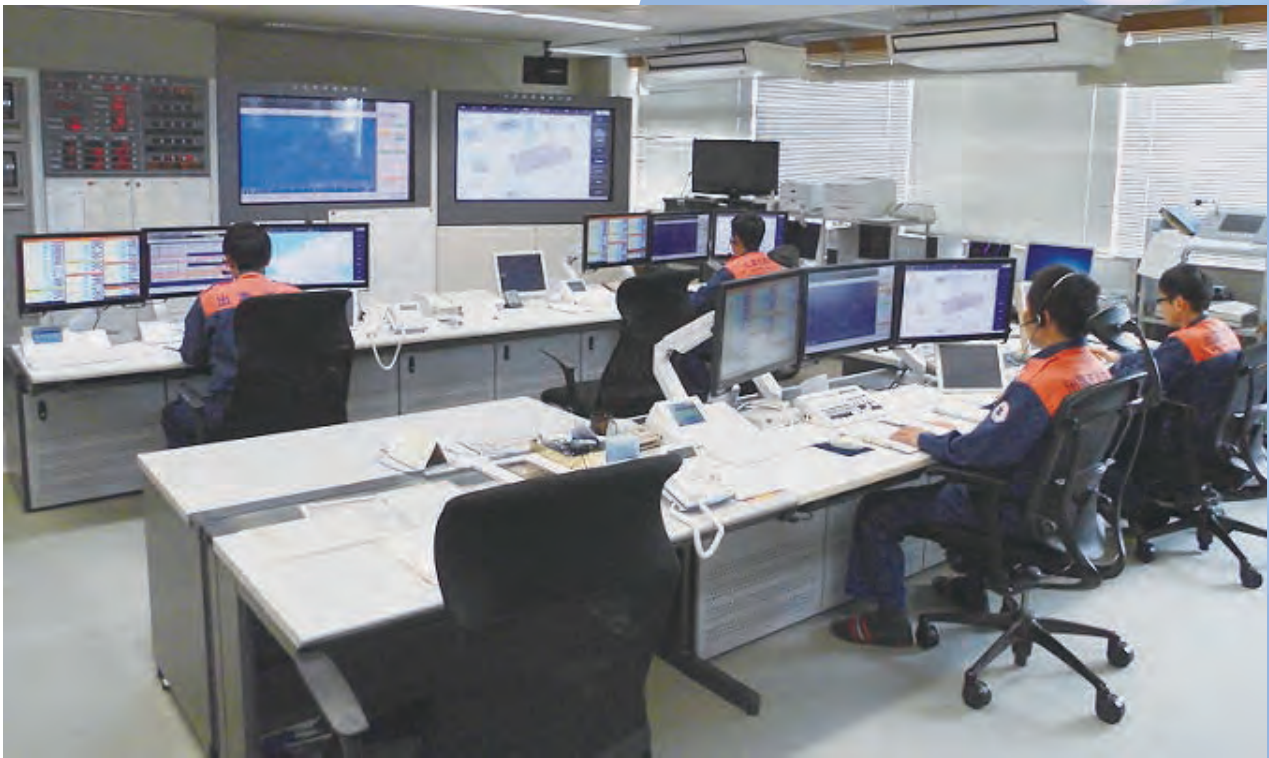
出雲市消防本部通信指令室
